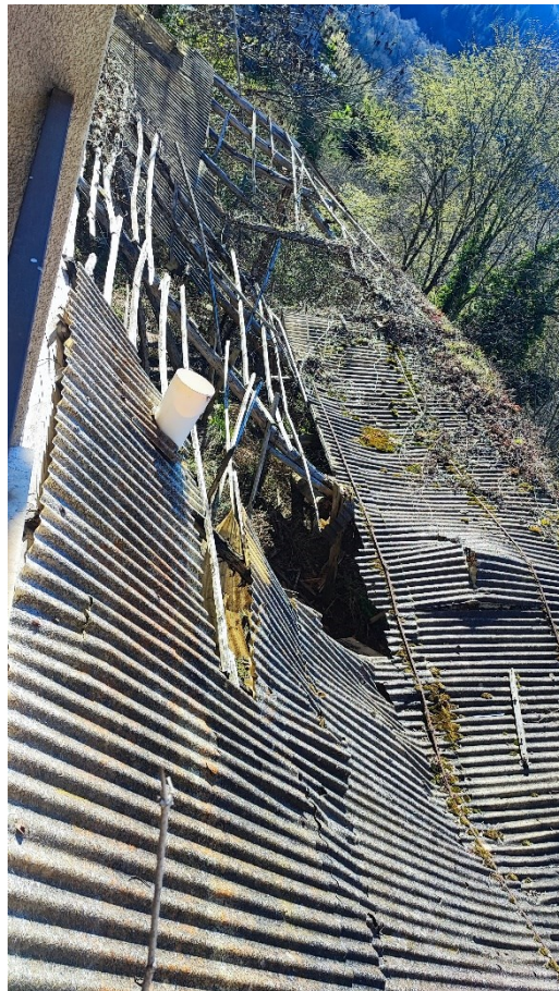
Tettoia – Porticato, già crollata, a tal ragione non sanabile, soggetta a rimessa in pristino
