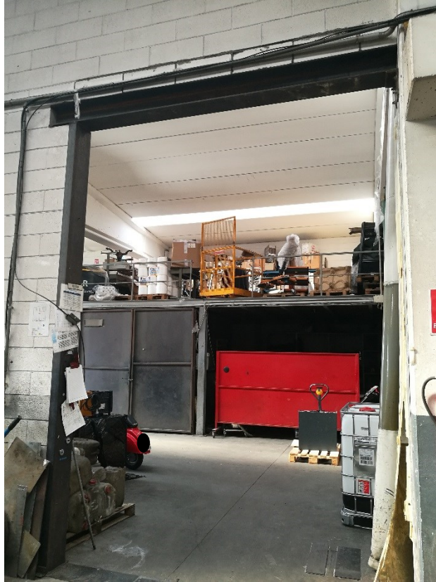
Figura 11: vista apertura (non autorizzata) verso u.i. adiacente
