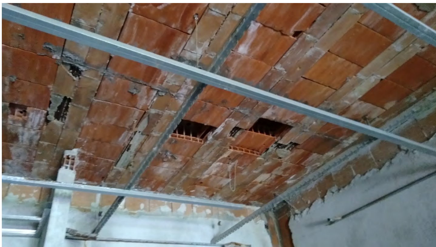
Fotografia N. 18 – Sub 430 al Piano Terra, dettaglio pignatte e travetti sfondellati
