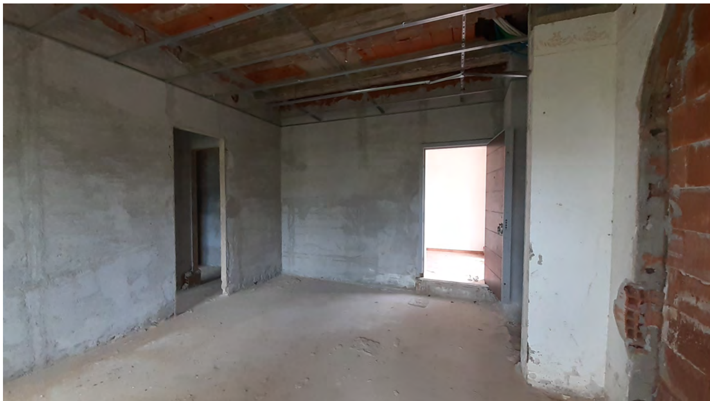
Fotografia N. 15 – Sub 428 al Piano Terra
