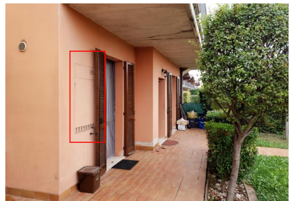
Foto 7: vista del giardino con la caldaia a incasso
