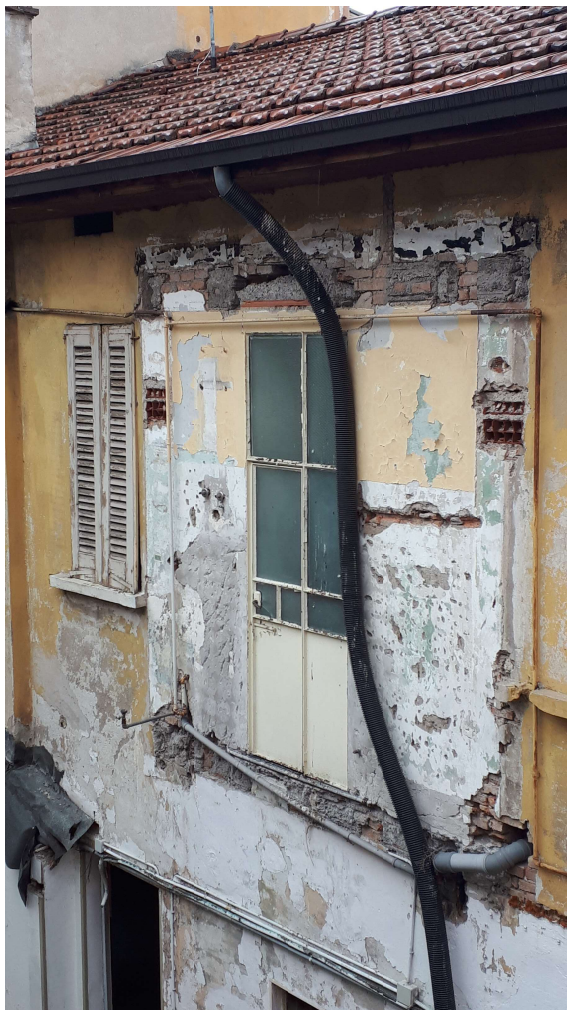
fotografia n° 7 – facciata ovest – balcone demolito
