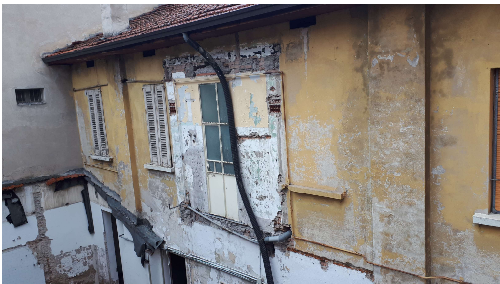
fotografia n° 6 – facciata ovest – balcone demolito
