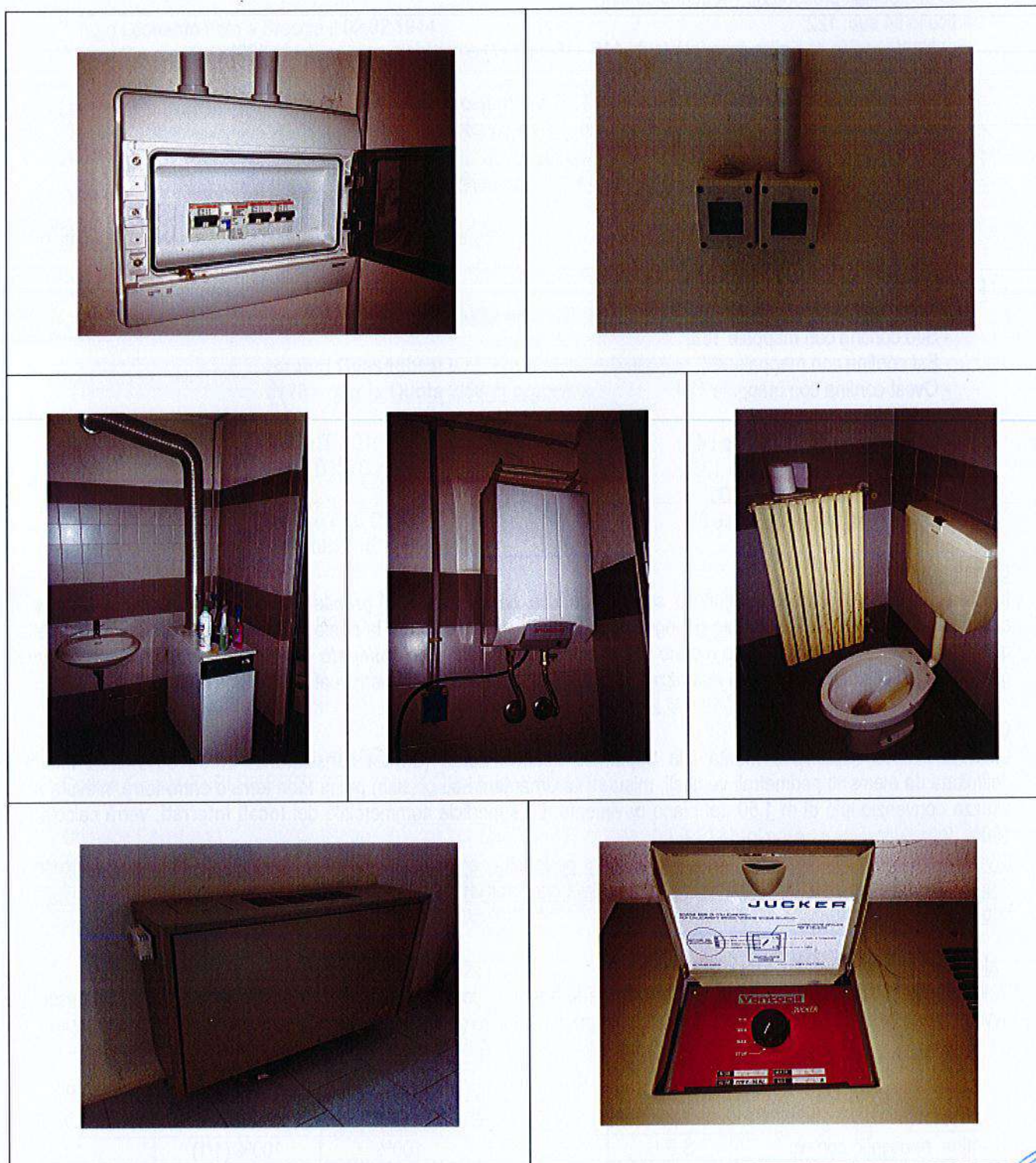
Fig. 10: Impianti in dotazione all'immobile
