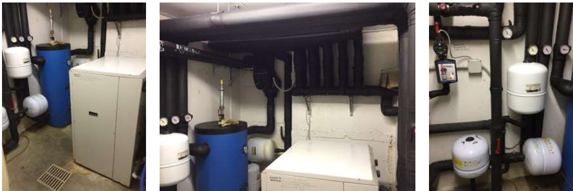
Fig. 05: centrale termica-impianto geotermico
