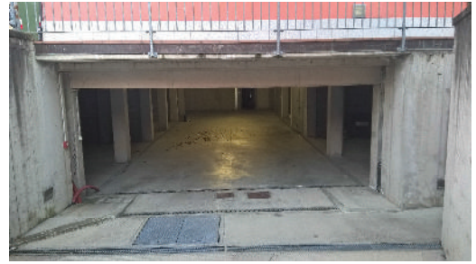
FOTO N. 56: ingresso corsello sub. 1 e unità subb. 14-15-16-17-18-19(lato sinistro) e unità 20-21-22-23 (lato destro)
