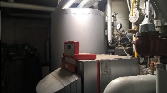
FOTO N. 61: centrale termica sub. 2
