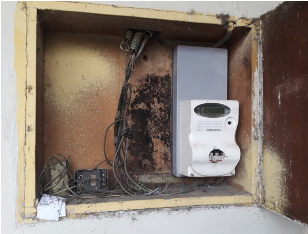
Foto 8: vano contatore E.E.
